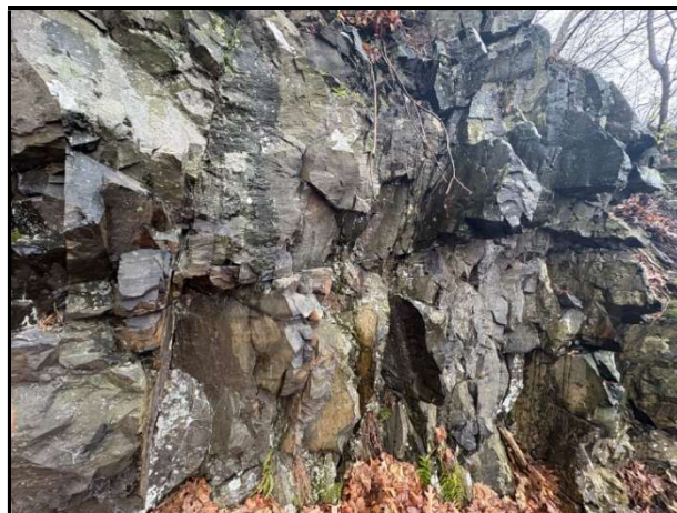
L'état d'une des parois de proche.
