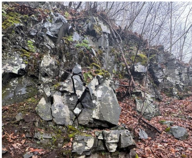
Photographie 12 : La présence de fissures clairement visibles
