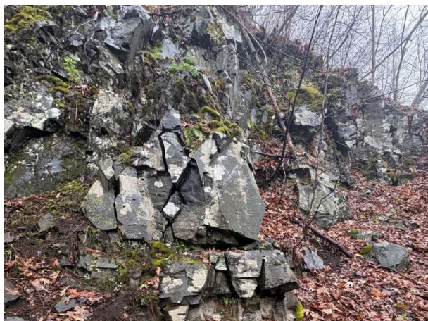
La paroi avec les fissures.
